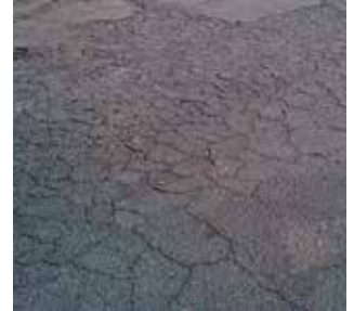
Şekil 4. Timsah Sırtı Çatlaklar
